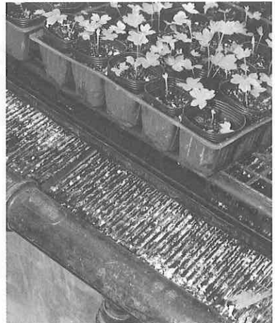
細いパイプ内に温水または冷水を通し、底面から暖冷房を行う苗生産用の設備。苗生産をを事業化するために導入した
