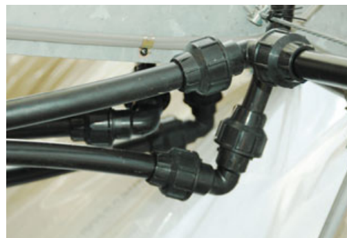
會田氏は、このイスラエル製ポリエチレンパイプの配管を気に入っている。塩化ビニールを原料としたVP管に比べて柔軟性があり、手作業だけで設置することが可能である。さらに太陽光や塩水、酸とアルカリ溶液、肥料などの耐久性に優れており、かつ費用が安い。
