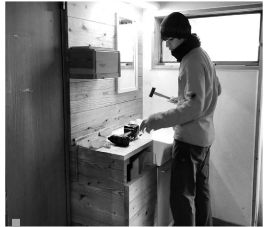
古くて掃除がしにくかった洗面所を改良。 釘が表面に出ないように工夫してます。
