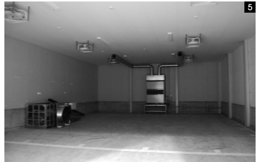
4 5 タマネギ乾燥冷蔵用のアスレーションシステム(南TOMTEN)。外気をプロパンガスによるバーナーで加熱し、35℃の温風を入口の反対側に設置された4基のダクトから乾燥室内に送り込み、入口側の下から排気を吸引する構造。スチール製のメッシュコンテナに入れられたタマネギの隙間を温風が通り抜け、13~15%程度水分を飛ばして乾燥させる。バーナーを切れば、そのまま低温貯蔵庫として利用可能。容量は、4段重ねで19×7列、約500t。外気の湿度が高い場合には内気循環にすることもできる。
