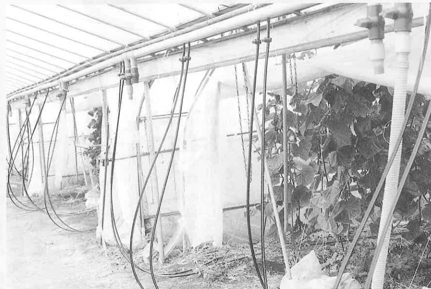
写真5 点滴灌水チューブの配管状態
