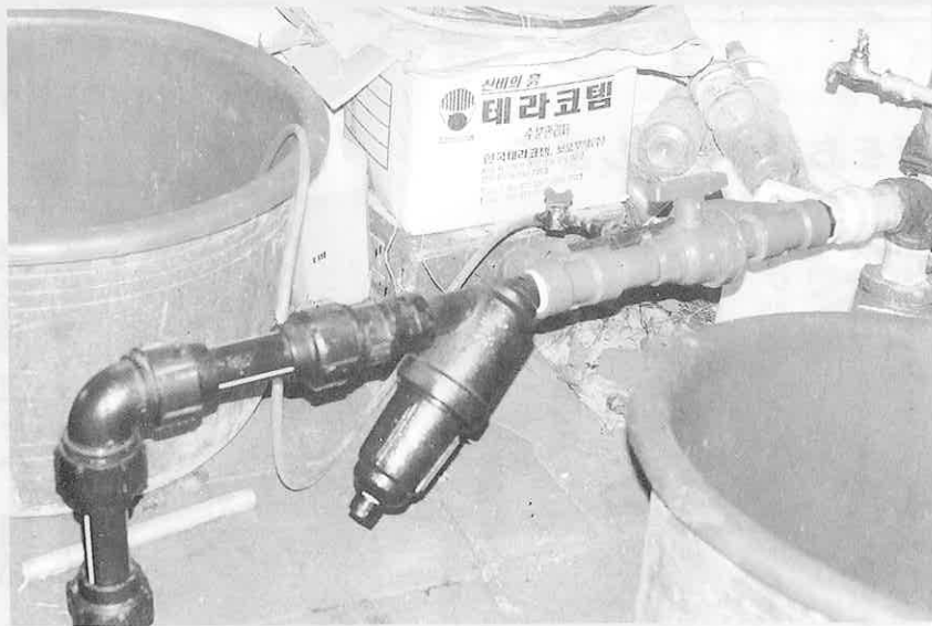
写真3 液肥混入器で有機液肥も施用している
